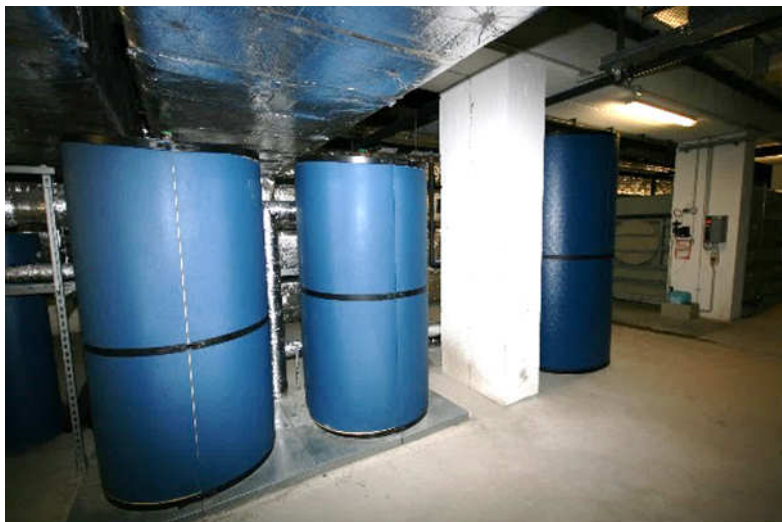
Abbildung 89: Drei wärmegeämmte Warmwasserspeicher im Technikkeller des Bambados
