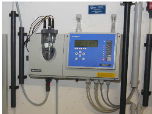
Abbildung 10: Chemische Messzelle zur Überwachung des Beckenwassers
